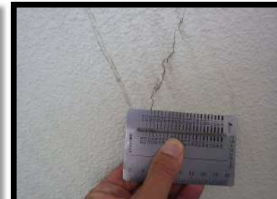
* バルコニー立入 梁・壁ひび割れ確認
