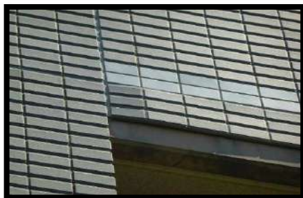
●○棟外壁タイルせり上がり
