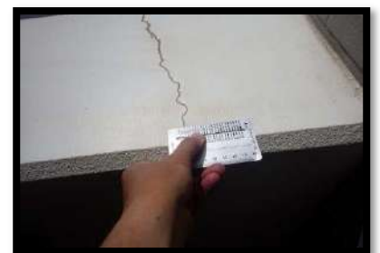
▲バルコニー手摺(梁)ひび割れ
