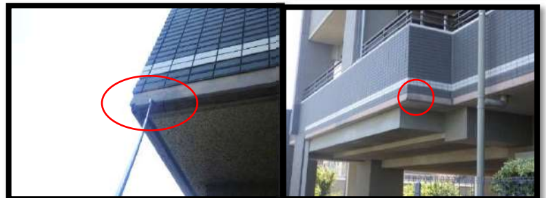
●○棟モルタル剥落の可能性
