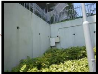
▲擁壁ひび割れ、汚れ
