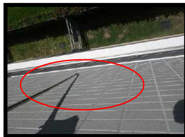
▲バルコニー手摺(梁)外壁タイル浮き
